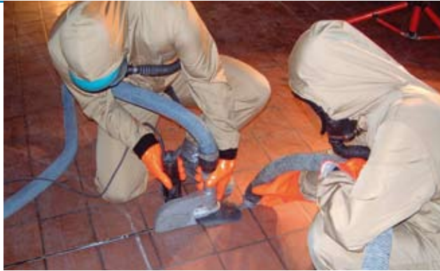
◀ Fjerning av PCB-holdig fugemasse i gulv (Foto: Arne Hugo Elde, Rivningsspesialisten AS)
