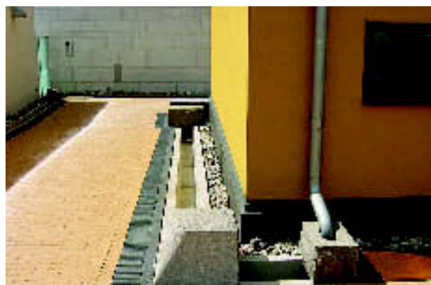
Nedføring av takvann til åpen renne i boområde.
