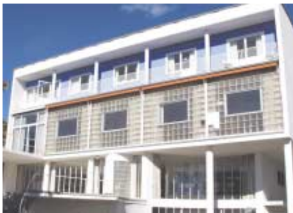
Mange av de opprinnelige glassbyggersteinene i fasaden på Villa Stenersen har begynt å sprekke.
